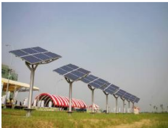
區內太陽能設施(日間)
