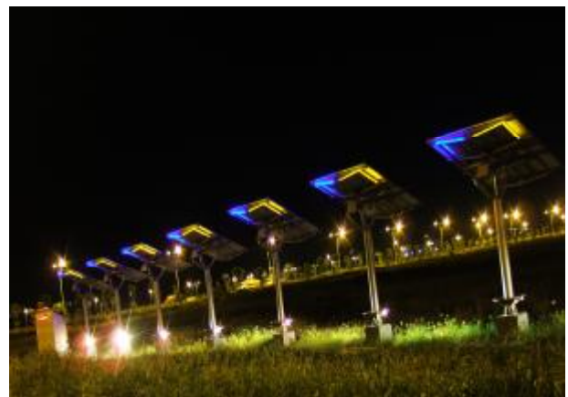
區內太陽能設施(夜間)
